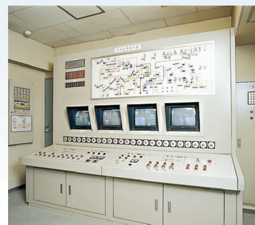
産業廃棄物リサイクル設備操作パネル
