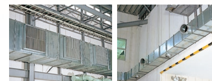
粗選別ヤード粉塵吸引装置
