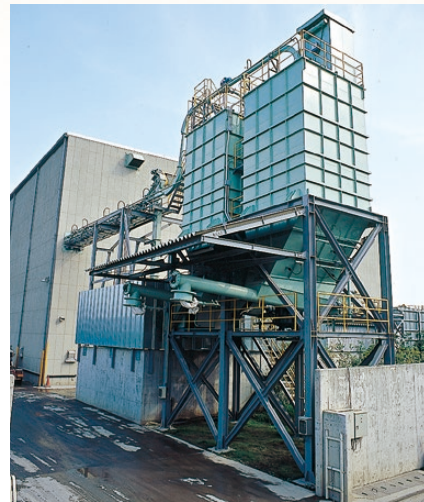
石膏粉製品タンク
