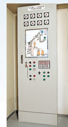
石膏ボードリサイクル設備操作パネル
