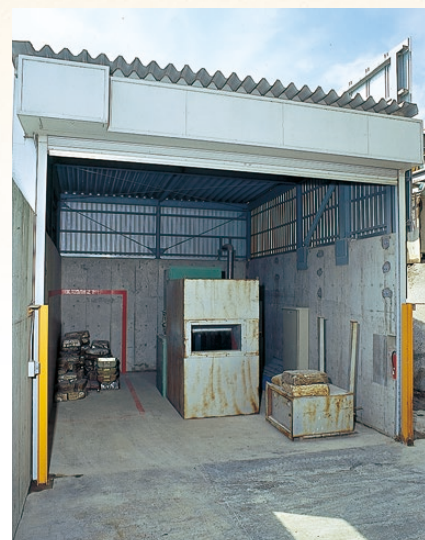
プラスチック減容固化機／発泡プラスチックをインゴットにします。
