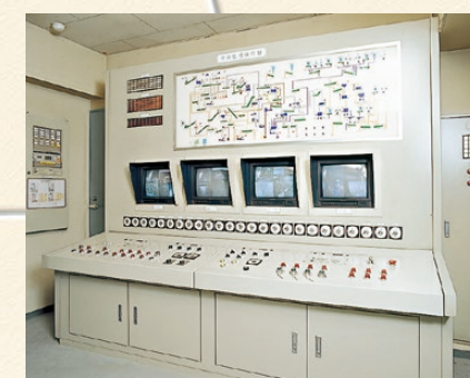
中央操作室のコントロールパネル
