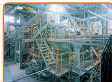
廃石膏ボード処理施設
