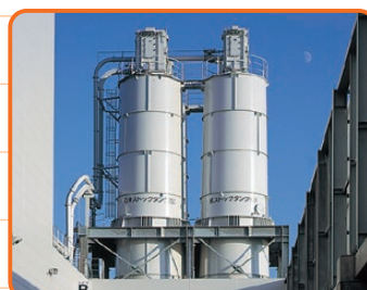
石膏粉製品タンク
