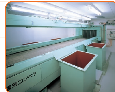
廃プラスチック類処理ライン用手選別コンベヤ
