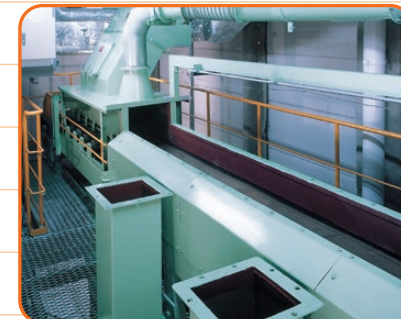
混合廃棄物処理ライン用碎石手選別コンベヤ
