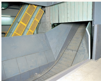
No.2供給コンベヤ／がれき類等を投入します。
