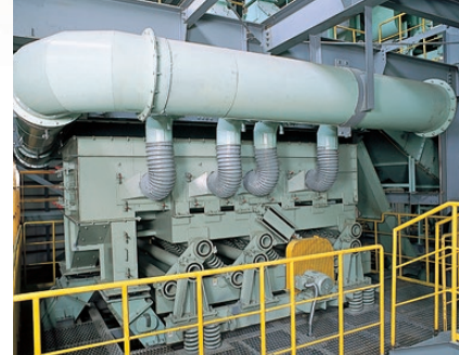
2次選別機(不燃物精選機)／不純物を除去した再生碎石を選別します。
