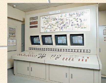
中央操作室のコントロールパネル
