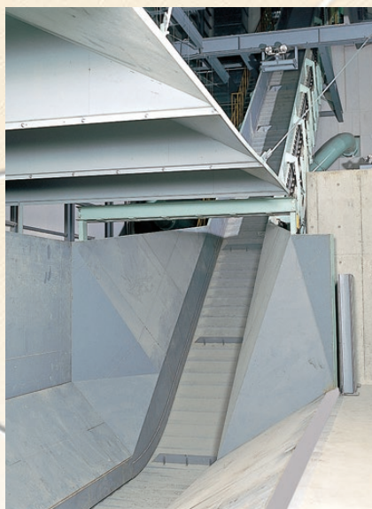
No.1供給コンベヤ／混合廃棄物を投入します。
