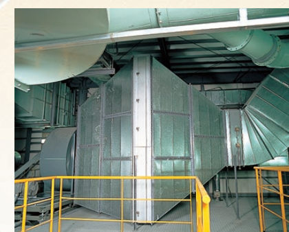
集塵機／精選別ヤードの粉塵を除去します。
