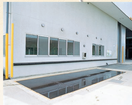
トラックスケール
