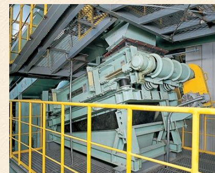
分級機／不純物を除去した再生砂を選別します。
