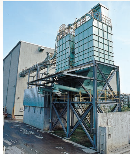
石膏粉製品タンク
