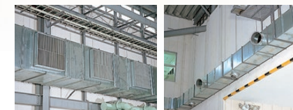
粗選別ヤード粉塵吸引装置
